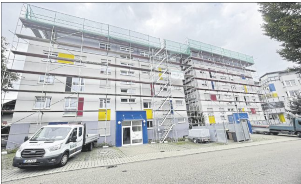
An der Schorndorfer Porzellanmanufaktur mussten nur Dacharbeiten durchgeführt werden. In so einem Fall wird ein Leegerüst hochgezogen und nur die oberste Etage als Arbeitsplatz vorbereitet.
